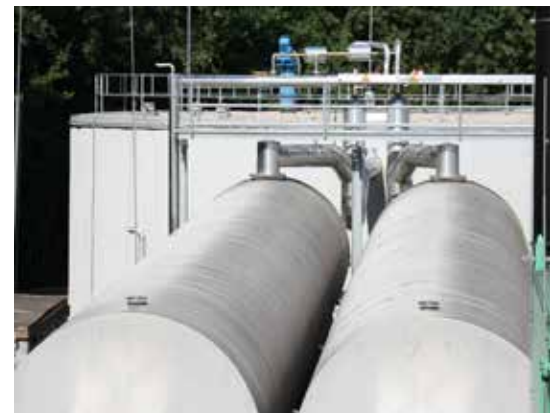
In den Fermentern entsteht Biogas, das dann in Gasmotoren in Strom und Wärme umgewandelt wird.
