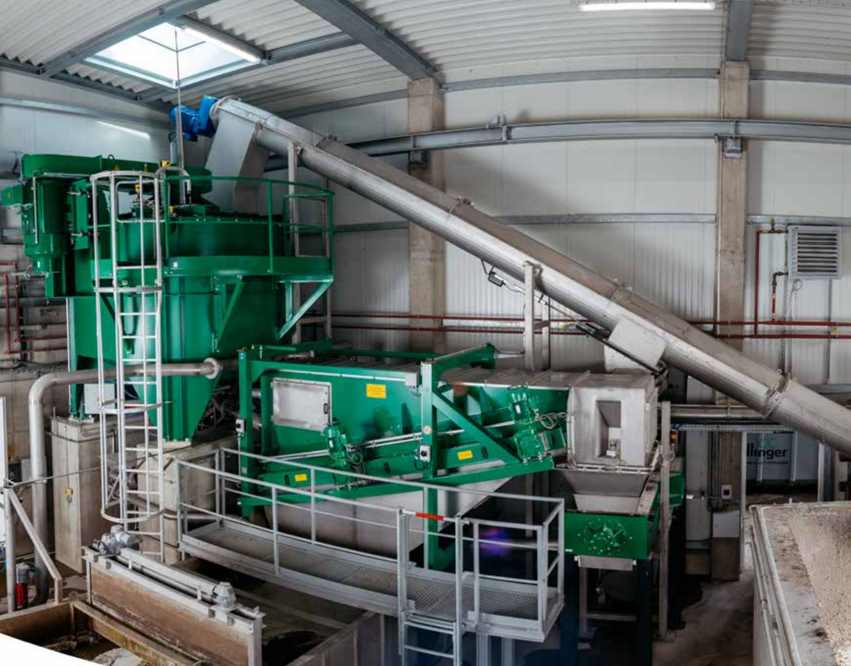
Nur für die Anlieferung werden die Hallentore geöffnet. Angefangen von der Befüllung des Zerkleinerers über das Lösen und Separieren bis zur Zuführung von Gärsubstrat in die Fermenter läuft alles automatisch.
